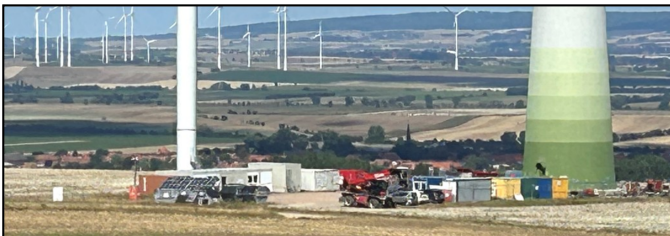
Zum Containerdorf mit Bauleitung, Versammlungsraum, Küche, Toiletten und mobilem 45 kVA-Solarenergie-Container gesellten sich bald auch zahlreiche Baufahrzeuge.
