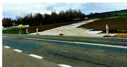
Die aus speziellen Aluminiumplatten gebaute zeitweilige Umfahrungsstraße – darüber rollen ab 24. März die extrem langen und tonnenschweren Schwerlasttransporte an Athenstedt vorbei in Richtung Dardesheim. FOTO: DENNIS LOTZMANN
