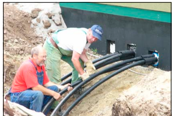
Hier kommen die Kabel von Dardesheim im Wind-Umspannwerk an
