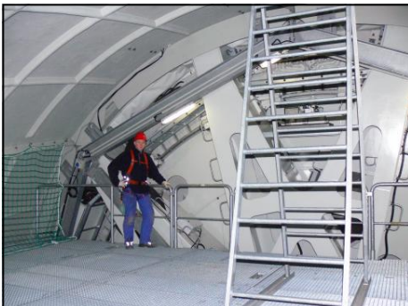
Servicetechniker René Schulz von der Dardesheimer Servicestation vor dem 6 MW Generator im 3. Stock der E-112
