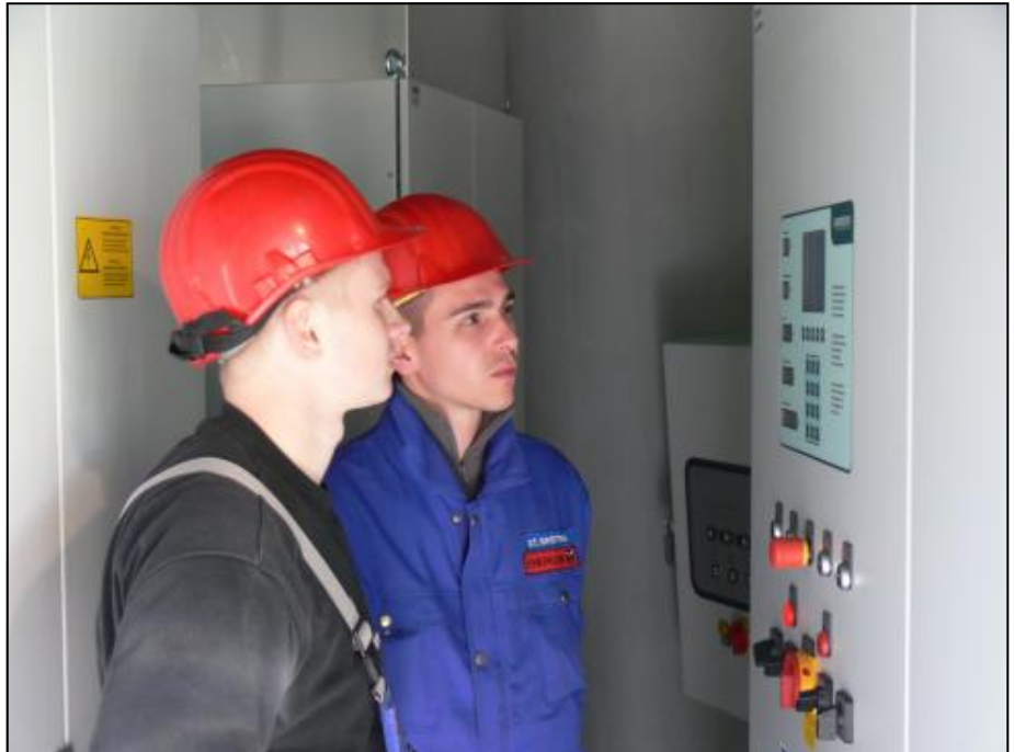
Die Enercon-Techniker René Schulz (links) und Steve Breiting (rechts) verfolgen die Produktionsdaten am Anlagendisplay im Turmfuß der E-112
