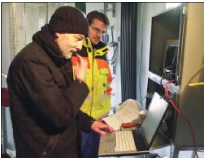
Nach Entwicklung der RegModHarz-Datenbrücke („IKT-Power-bridge“) schafften Siemens-Mitarbeiter Dr. Martin Winter (li.) und Enercon-Servicetechniker Mirko Morche am 24. 4. in Windanlage 22 die letzten technischen Voraussetzungen zur Anbindung des Windparks an die Kombikraftwerksleitwarte, die auch auf der HannoverMesse vom 4. - 8. April und am 30.4. in Halberstadt im Verbund mit anderen EE-Anlagen vorgeführt werden soll
